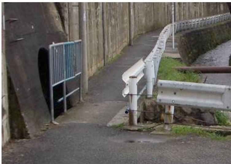
2009年3月14日現在：ガードレールの末端が尖っており、危険である。
